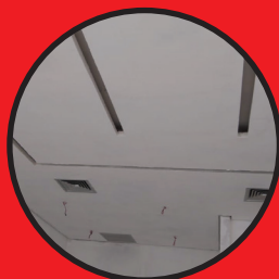
Forro em drywall
